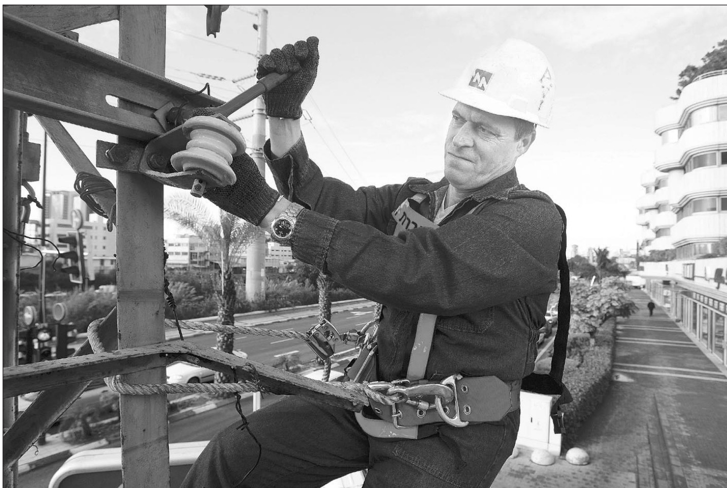
ת"א, עיר באפור (4). אבי שמואל, 46, אלמן, אב לשלושה, עובד בחברת חשמל, מחוז דן, כבר 20 שנה, עובד על רשת עילית. בחורף, בנוסף על העבודה השוטפת, נאלץ להתמודד עם חוטים קרועים ועמודים שקרסו. התקלות הקשות מתרחשות בדרך כלל בזמנים של גשם כבד ורוחות, והתיקון אורך לעתים שעות ארוכות. אבי: „חשוב לי שתהיה יותר הבנה, סבלנות וסובלנות בין האנשים אצלנו בארץ“
